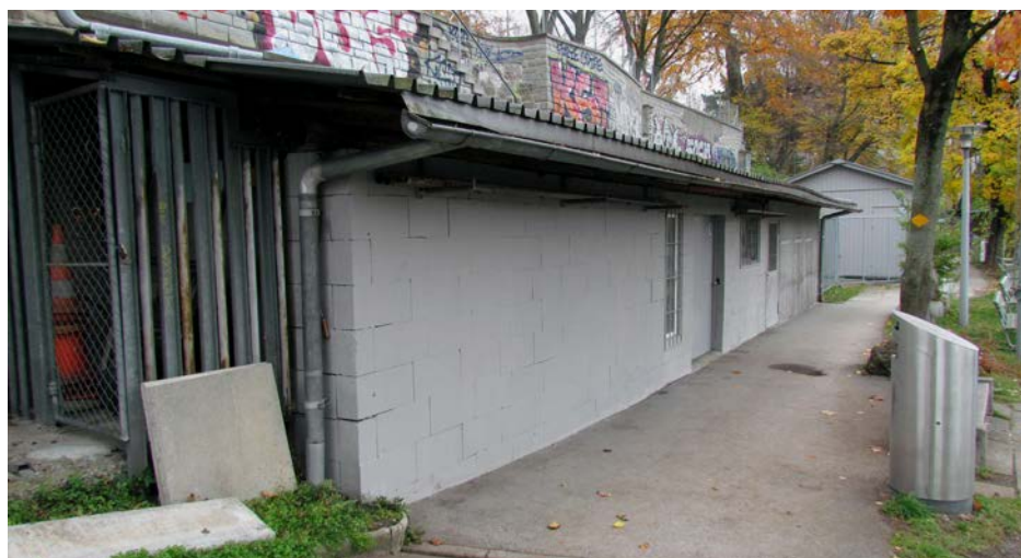
Diese Bootshausfront soll mit Schiebetüren versehen werden. Das schafft Platz für rund drei Dutzend zusätzliche Boote. (Foto: Jürg Christoffel)
