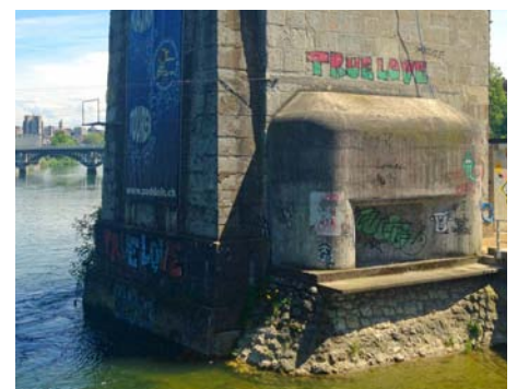
Dieser Brückenpfeiler unterhalb des Bootshauses Letten wurde von 1939 bis 1988 als militärischer Bunker genutzt. (Foto: aaj)
