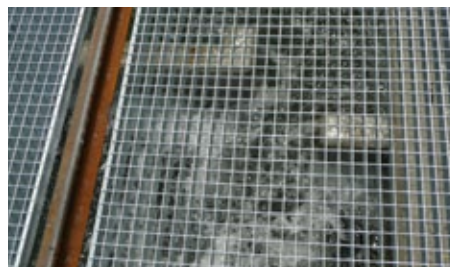
Blick auf eines der 37 Aufstiegsbecken. Links eine Schiene der Kahnrampe.
