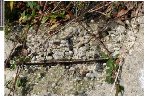
Die Stützmauer ist stellenweise stark beschädigt.
