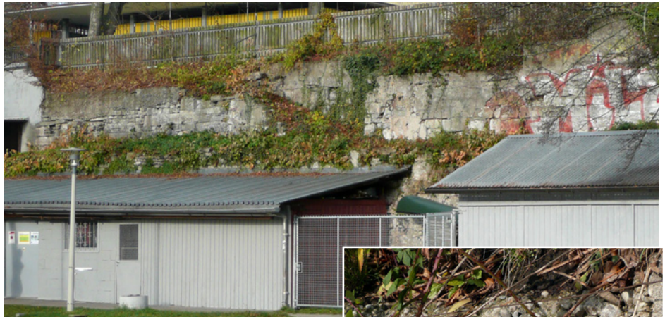
Die Stützmauer oberhalb dieser WVZ-Bootshäuser wird von der Stadt Zürich saniert, weil sie in sehr schlechtem Zustand ist.
