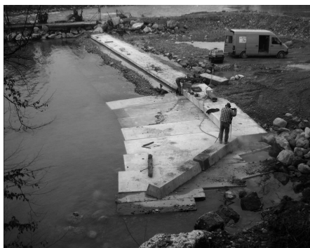
Der abgesunkene Wehrteil auf der linken Seite wurde rekonstruiert. (© Endless Circle Productions)
