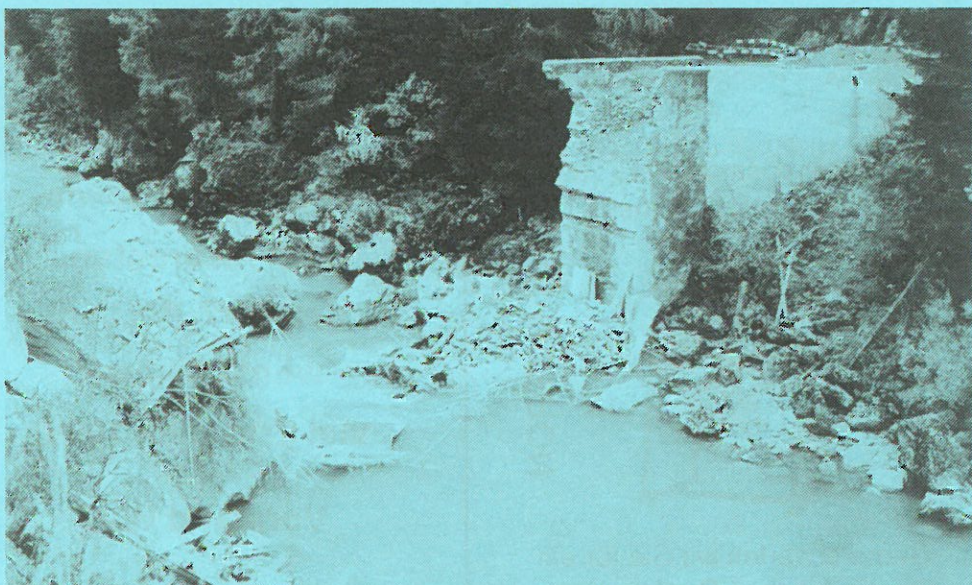
Die eingestürzte Brücke über den Inn unterhalb des Dorfes Ardez (Bild: Dieter Neff).
